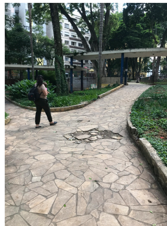
Imagem 5 - Buraco no piso
